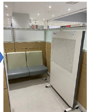
咳嗽等がある患者用待合 エアパーテーション設置
